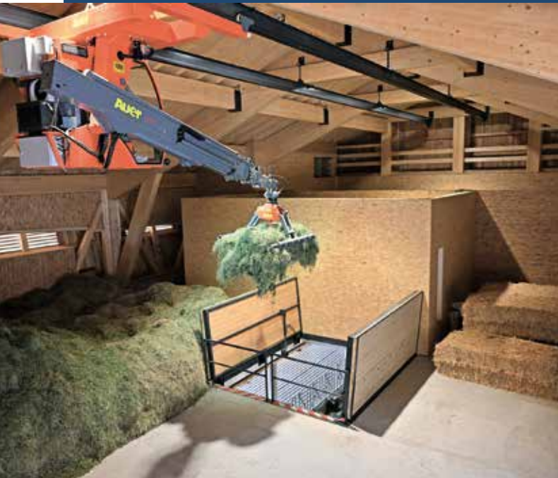
DAS HEU wird mit warmer Trocknungsluft über eine Dachabsaugung in der Belüftungsbox belüftet, Ventilator und Entfeuchter stammen aus dem Hause Lasco.
