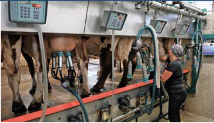
DER 5ER-SIDE-BY-SIDE-MELKSTAND ist gebraucht eingebaut. „Die Qualität der Melkarbeit ist unvergleichbar“, so Annemarie.
