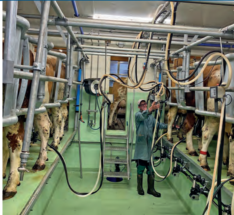
DER 2X5ER-SWING-OVER-MELKSTAND ist sehr geräumig und besonders hell gestaltet. Firma Karner hat das Melkhaus geplant und die Technik umgesetzt.
