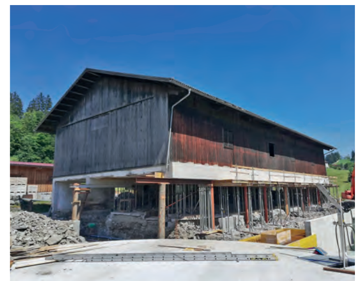
AM 26. MAI wurde die Baustelle eröffnet und bereits am 16. September konnte der Einzug erfolgen.
